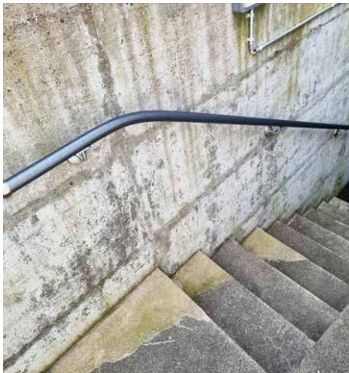
Handlauf bei einem Treppenabgang zur Tiefgarage
