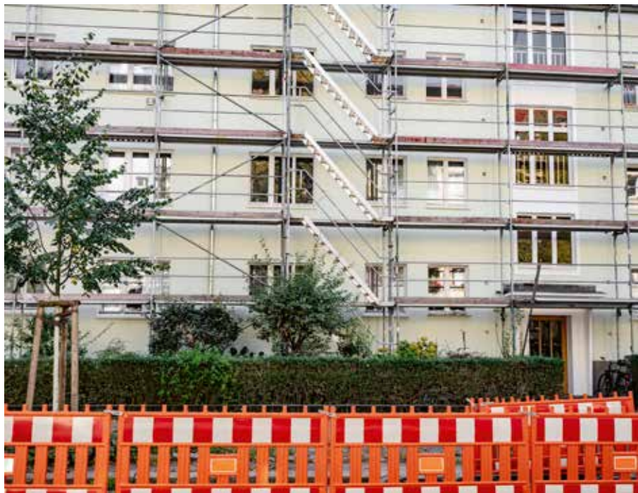
Ehe das Gerüst steht, muss geklärt sein, ob die Mieterschaft während der laufenden Sanierung in der Liegenschaft wohnen kann. BILD: 123RF.COM
