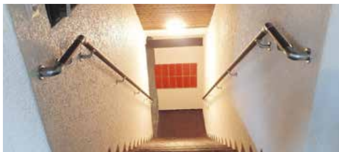
Fluchttreppen müssen immer beidseitige Handläufe haben
