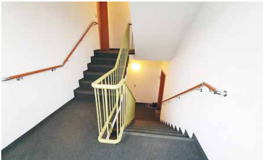
Zusätzlicher, wandseitiger Handlauf für optimale Sicherheit
