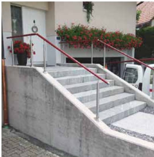
Normgerechte, beidseitige Handläufe im Aussenbereich
