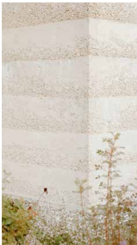
Die Kalkaussinterungen an den Fassaden werden verschwinden.
