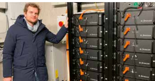
Daniele Farrace neben den Modulen der Quartierbatterie.
