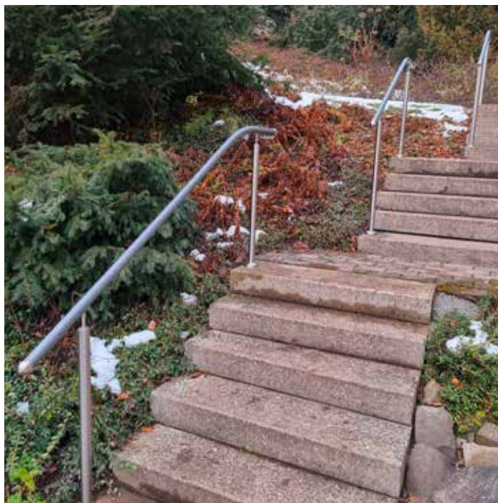
Aussenhandläufe bei einer Liegenschaft mit Publikumsverkehr
