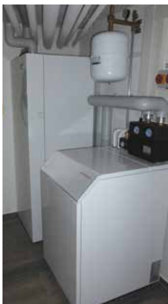
Mit dem Einbau der umweltfreundlichen Luft-/Wasserwärmepumpe von Weishaupt sind nun zehn weitere Häuser auf dem neusten Stand.
