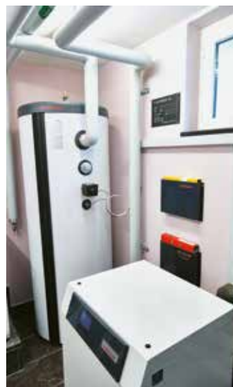
Dank der umweltfreundlichen, effizienten, leisen und langlebigen Sole/Wasser-Wärmepumpe profitiert Familie Kalac von einem Heizsystem mit den niedrigsten laufenden Kosten.
