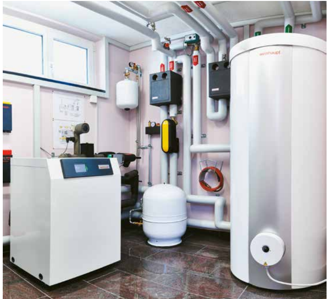
Die im Zuge einer Heizungssanierung eingebaute Sole/Wasser-Wärmepumpe WWP S 11 ID inklusive Energiespeicher und Warmwasserspeicher WAS Eco von Weishaupt sorgt im 1939 erbauten Dreifamilienhaus seit letztem Winter für Wärme – und im kommenden Sommer für angenehmes Klima.
