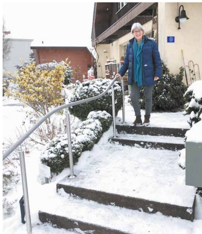
Gerade im Winter besteht auf Aussentreppen ein hohes Sturzrisiko.
