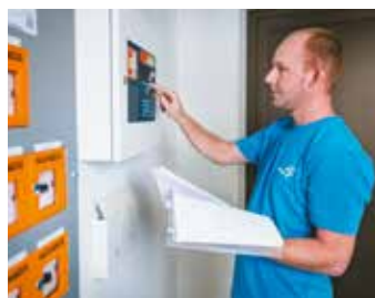
Einer unserer technischen Hauswarte bei der Überprüfung einer Brandmeldeanlage
