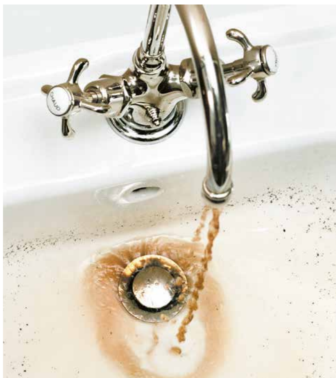
Rostwasser im Lavabo deutet auf die Alterung der Trinkwasserinstallation hin.
