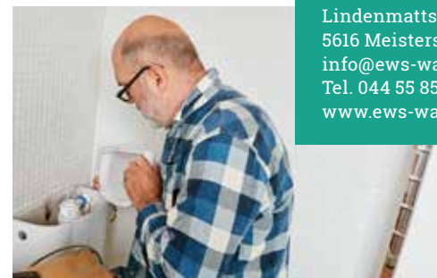
Kalkstein im Spülkasten wird verhindert.
