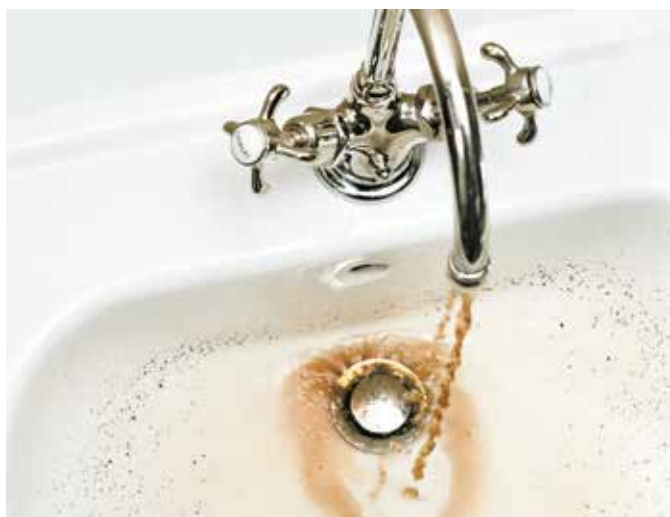
Rostwasser im Lavabo deutet auf die Alterung der Trinkwasserinstallation hin.
