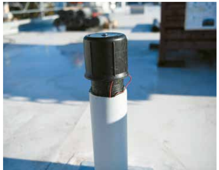
Die Sika Sensoren im Kontrollrohr messen die relative Feuchtigkeit und geben sofort ein Signal ab, wenn ein zu hoher Wert erreicht wird.
