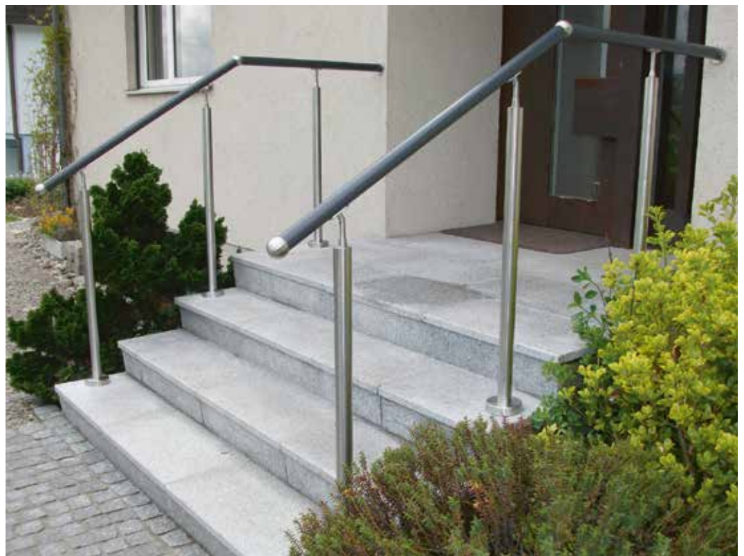
Beidseitiger Handlauf aus einem Aluminiumrohr ummantelt mit einem Laminat und aufgeschraubten Chromstahlstützen
