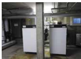
Die beiden Weishaupt Thermo Condens WTC-GB 300 Gas-Brennwertkessel in der Bärenweid-Zentrale
