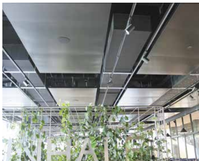
Das Kühl- und Heizdeckensegel KKS mit eingebauten Lautsprechern und Leuchten. (Bild 2)
