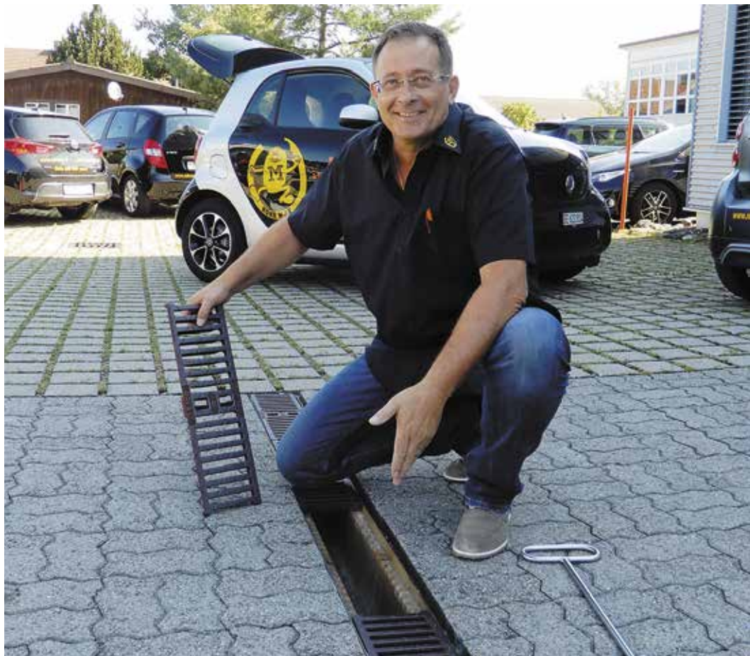
Erfahrene RohrMax-Kundenberater überprüfen die Funktionstüchtigkeit von Abwasserrohren, Schächten + Co.
