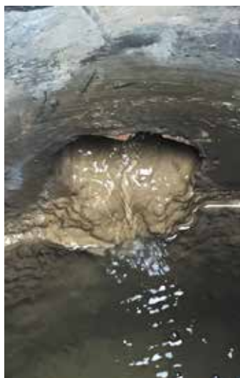
Einlauf in einen Meteorschacht: In den Sickerleitungen sieht es ähnlich verkalkt aus.
