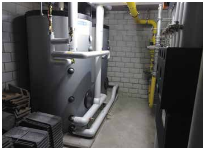
Die beiden 600 l-Boiler und rechts die Modulverteiler-Elemente von Weishaupt in einer der Unterstationen
