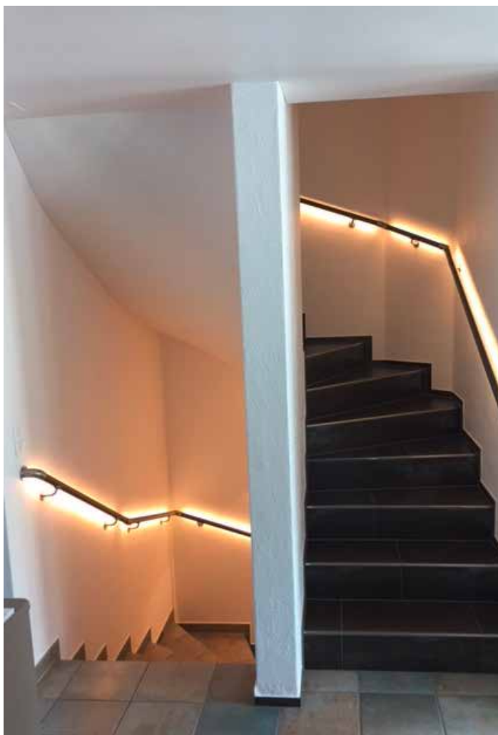
INNENHANDLAUF mit durchlaufendem Licht
