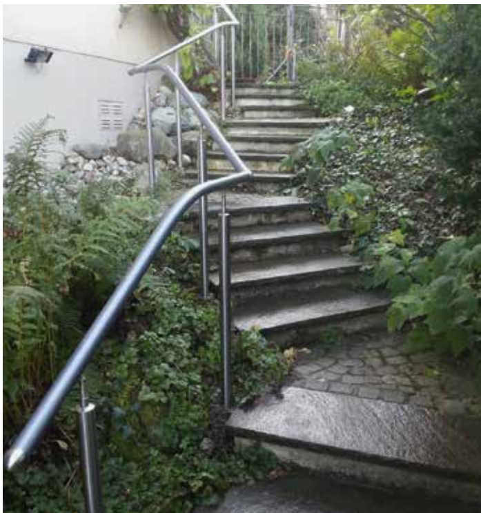
Eleganter Flexo-Handlauf aus handwarmen Aluminium an einer Treppenanlage
