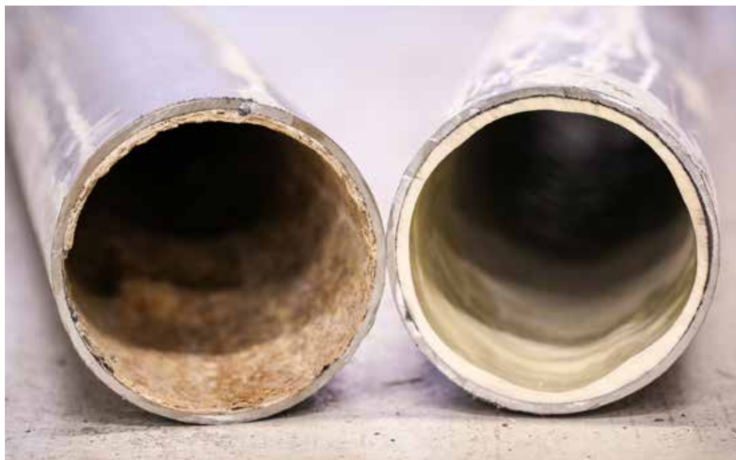
Vorher und nachher: Leicht lässt sich das Kunstharz auftragen, und Schicht für Schicht entsteht eine dichte, selbsttragende und widerstandsfähige Abwasserleitung mit einer Wandstärke von zwei bis fünf Millimetern.
