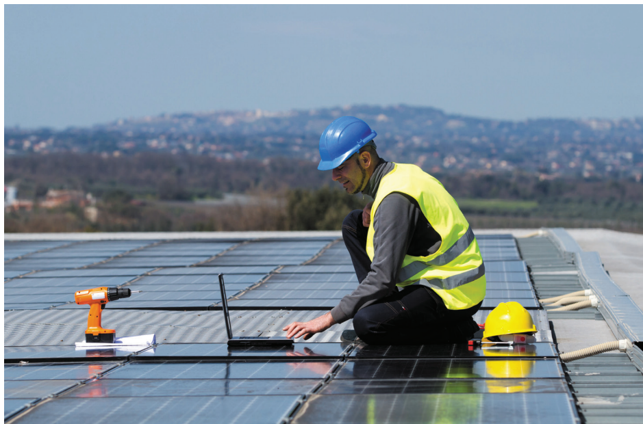
Il fotovoltaico architettonicamente integrato applicato a edifici nuovi o ristrutturati aumenta l'efficienza energetica (foto:123rf.com)
